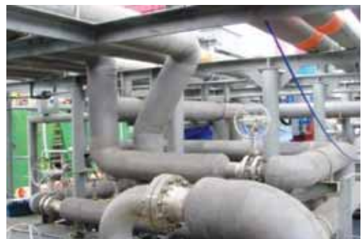
LNG Pipe Insulation for Fuel Tank
