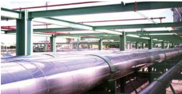
LNG Terminal Pipe Insulation
